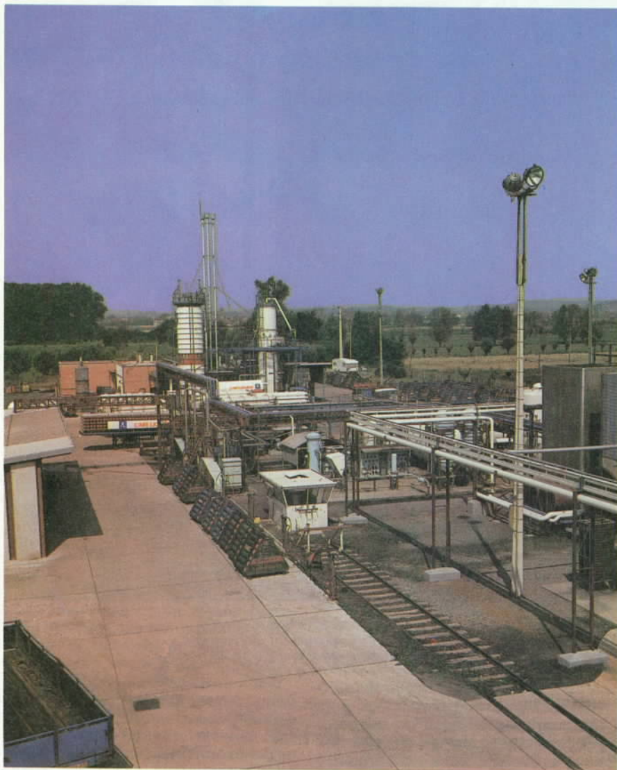
Près de Douai, l'installation de production d'hydrogène de Frais Marais (ci-dessus). Sur cette photographie, on voit, au fond : à gauche le réservoir de stockage de 50 000 litres d'hydrogène liquide, à droite le liquéfacteur de production. Les structures triangulaires au premier plan servent au stockage gazeux. L'hydrotonne de l'usine de l'Air Liquide d'Isbergues, dans le Pas-de-Calais (ci-contre), produit, à partir de gaz naturel provenant du gisement de Groningue en Hollande, 700 à 3 300 m 3 par heure d'hydrogène pur.
